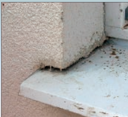
Отслоения, растрескивания и разрушения армирующего и декоративного слоев в местах примыкания к отливу появились из-за неправильно организованного деформационного шва
