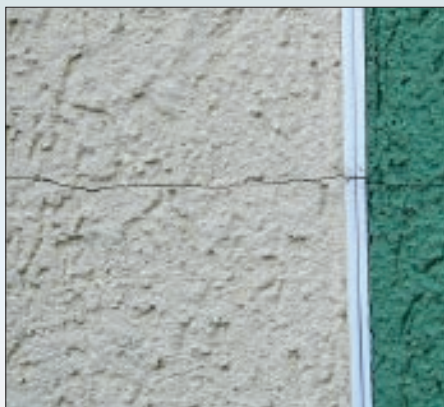
Произошла деформация теплоизоляционных плит в центре или по краям вследствие несоблюдения технологии нанесения клеевого состава и дюбельного крепления.
