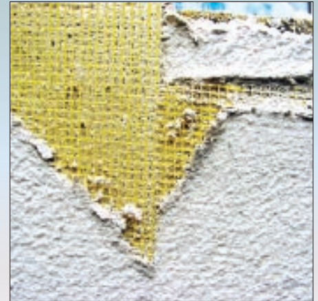
Трещины и разрушения армирующего слоя при производстве армирования с помощью декоративной штукатурки вследствие невыполнения перехлеста стеклотканевых сеток
