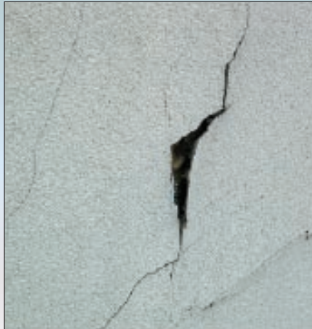
Растрескивание и разрушение армирующего слоя вследствие воздействия внешних нагрузок (превышение предела прочности армирующей сетки).
