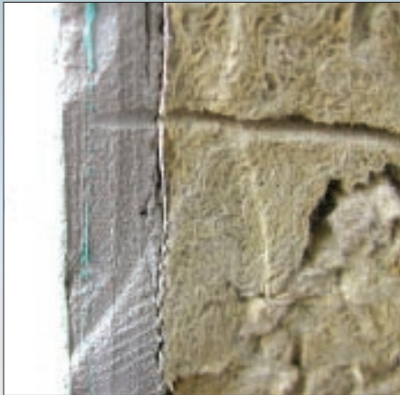
Растрескивание и расслоение армирующего слоя вследствие нарушения технологии нанесения (толщина армирующего слоя превышает допустимые показатели, сетка установлена на теплоизоляционной плите).
