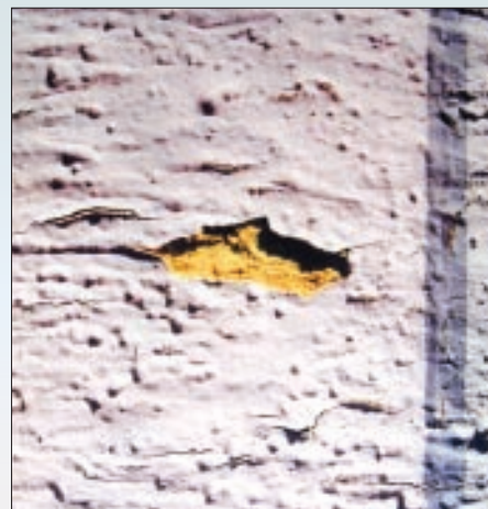
В процессе монтажа не была установлена армирующая сетка.
