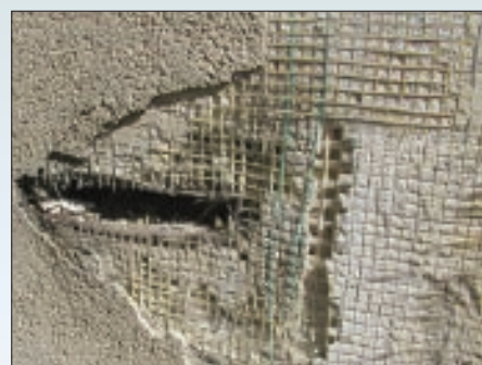
Растрескивание и расслоение армирующего слоя по его толщине вследствие нарушения технологического процесса нанесения (после монтажа сетки произошло высыхание первого слоя, последующее шпаклевание проводилось по образовавшейся полимерцементной пленке).
