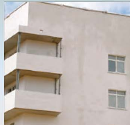
Намокание поверхностей теплоизоляционной системы фасада из-за неправильно организованного укрытия парапета и протечек
