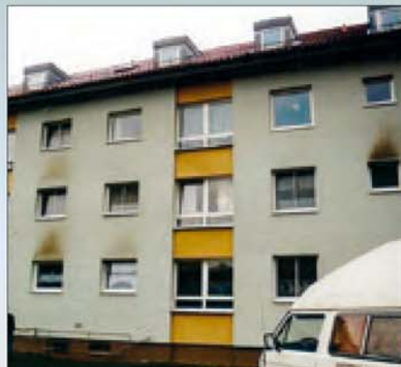
Загрязнения декоративного покрытия вследствие неправильного функционирования системы вентиляции и активного выброса воздуха через оконные проемы
