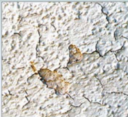
Дефекты возникли на минеральной декоративной штукатурке из-за несоблюдения режима высыхания поверхности после промывки фасада с использованием агрегатов высокого давления
