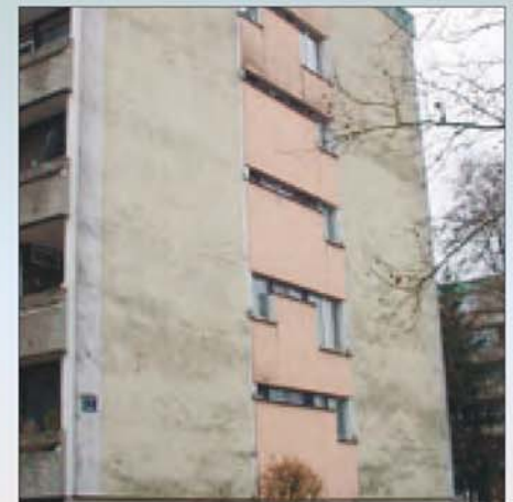
Растительный и грибковый налет на плоскостях фасадов
