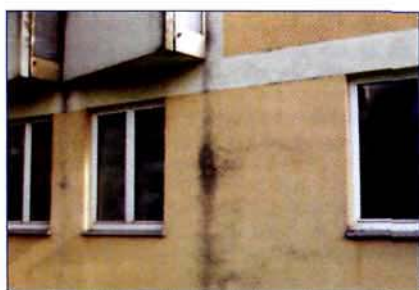
■ Рис. 15. Место на фасаде, где отмечается большое образование водорослей вдоль зоны усиленного водостока, возникающего под воздействием ветра из-за боковых ограждений балконов. Непосредственно под балконом образование водорослей явно меньше, чем на незащищенной поверхности стены
