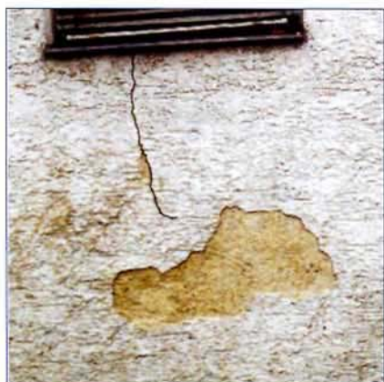
■ Рис. 16. Трещина в стене и повреждение штукатурки западного фасада здания без теплоизоляционных фасадов, расположенного по соседству с объектом 32. Трещина в стене под окном (очерчена) продолжилась в штукатурке. Верхний слой штукатурки отчасти отделился от нижнего. Таких повреждений удастся в целом избежать при наличии теплоизоляционных фасадов благодаря теплоизоляционному слою, который разъединяет каменную кладку и штукатурку, применению добавок в штукатурный состав, а также армированию штукатурки
