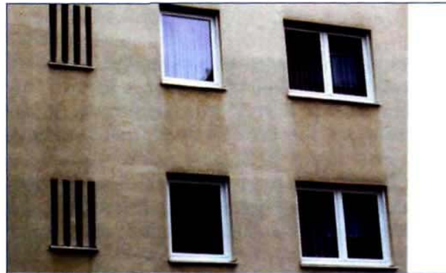
■ Рис. 13. Часть северного фасада объекта 51. Спустя 17 лет после ремонта при помощи покраски в 1987 году. Участки межоконных простенков окнами, сильнее смачиваемые дождевой водой, несколько светлее. Этот факт позволяет заключить, что увлажнение дождевой водой имеет здесь следствием не образование водорослей, а эффект очистки поверхности фасада
