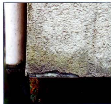
■ Рис. 17. Пример повреждения на нижнем окончании фасада западной ориентации в результате проникновения влаги на завершающий профиль, вызванного, вероятно, дефектной водосточной трубой. Такие повреждения следует устранять по мере их возникновения, независимо от потребности фасада в общем ремонте
