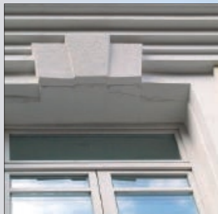
Трещины на границе архитектурных элементов с последующей передачей напряжений на армированный слой
