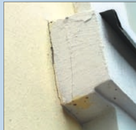
Разрушения в местах примыкания архитектурных элементов. Установленный отлив не укрывает всю поверхность
