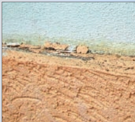
Верхняя кромка архитектурного элемента выполнена с уклоном в сторону основания, что привело к накоплению снега и разрушению отделочного слоя
