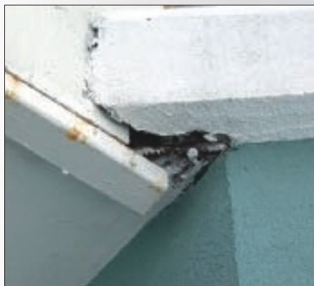
Процесс коррозии металлических закладных и несущих элементов
