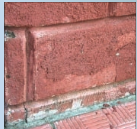
Разрушения отделочного слоя в цокольной части здания вследствие неправильного выбора материалов
