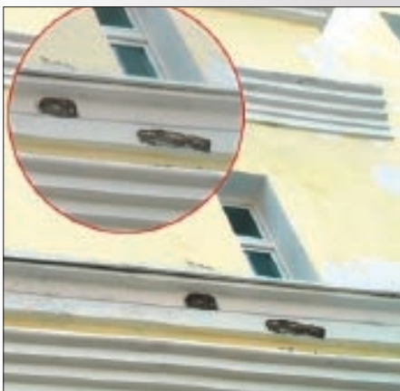
Разрушения архитектурных элементов, выполненных из тяжелых цементосодержащих материалов
