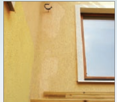
Дефекты внешнего вида из-за разности оттенков окрашенной поверхности вследствие несоответствующего подбора колерованного состава
