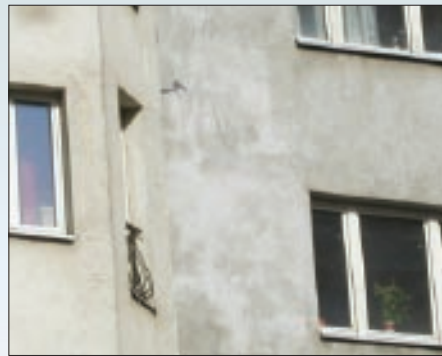
Намокание лакокрасочного покрытия вследствие применения лакокрасочных материалов с высоким водопоглощением с последующим появлением белесых пятен на поверхности из-за выхода из армированного слоя солей (выщелачивание)
