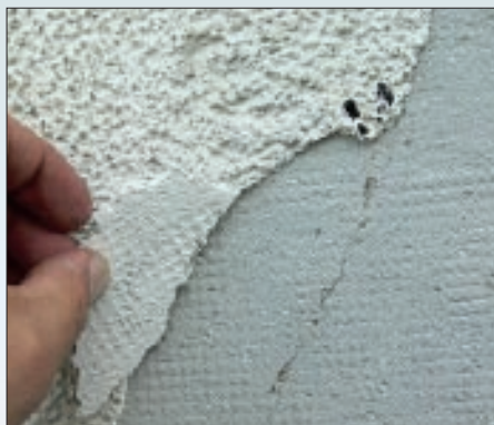
Отслаивание декоративного покрытия вследствие неправильного выбора грунтового состава. Грунтовка не применялась или использовалась неподходящая для данного вида покрытий
