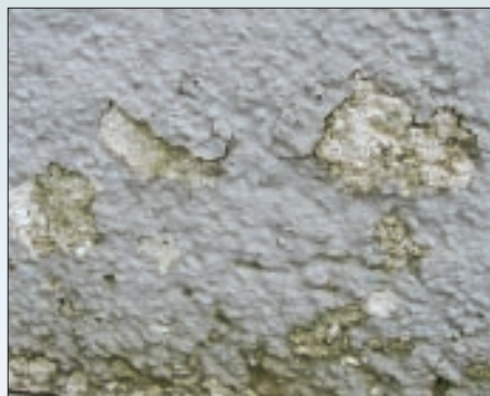
Отслаивание лакокрасочного покрытия вследствие применения окрасочного материала, не предназначенного для данного вида системы. Например, применение акриловых лакокрасочных материалов на системах теплоизоляции с минераловатной плитой
