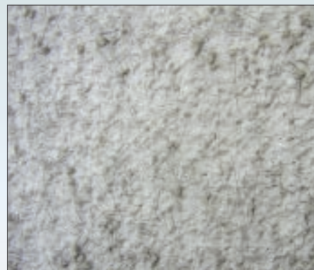
Дефекты лакокрасочного покрытия вследствие нарушения технологии нанесения. Окраска декоративного покрытия производилась при температурах окружающей среды и основания ниже +5^{\circ}\text{C}
