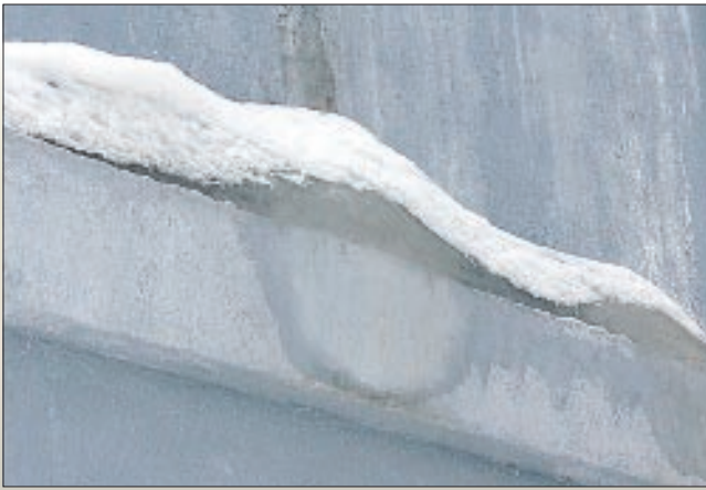
Намокание и последующие разрушение отделочных слоев с проникновением влаги в глубь теплоизоляционных плит из-за отсутствия предусмотренных отливов на архитектурных элементах.
