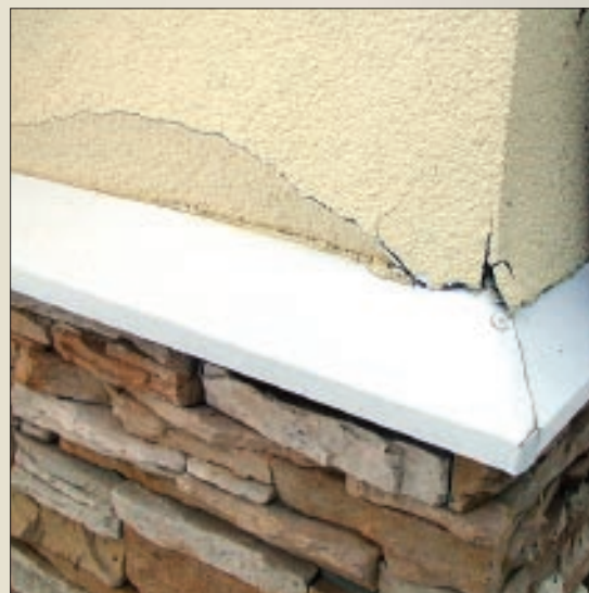
Разрушение отделочного и армирующего слоев из-за применения в цокольной части здания минераловатных плит с последующим активным водопоглощением и выполнения жестко организованного стыка теплоизоляционной системы к неутепляемым частям здания.
