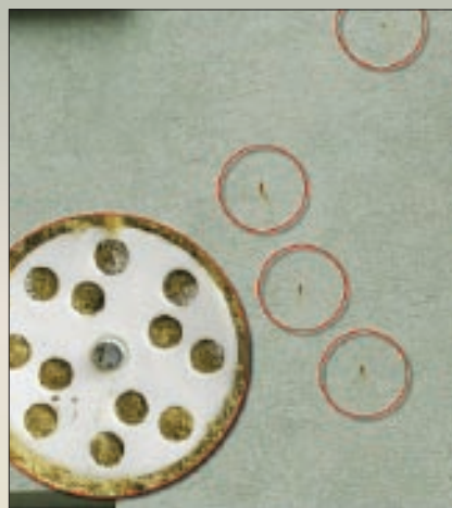
Пятна ржавчины вызваны коррозией элементов механического крепления с неизолированными сердечниками.
