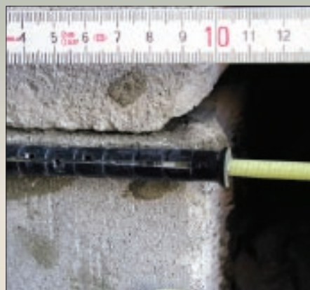
Монтаж теплоизоляционной системы производился на здании с большими отклонениями поверхности от вертикали. Дополнительный расчет и увеличение длины дюбелей не производилось.
