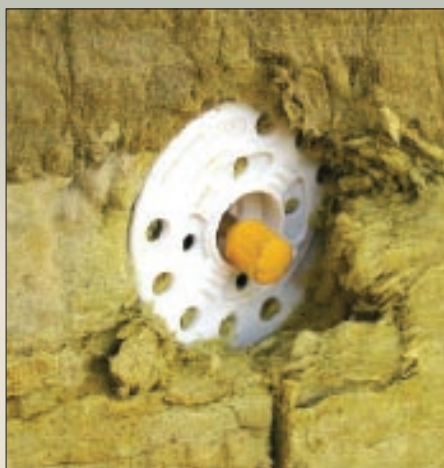
Нарушение технологии и несоблюдение технологических требований привело к установке дюбелей с перекосом и излишним заглублением.
