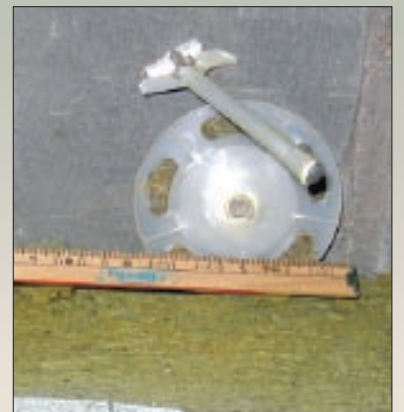
При монтаже использовались дюбели, не пригодные и/или не предназначенные для использования в фасадных системах теплоизоляции. Например, дюбели из полипропилена — материала, который обладает низкой морозостойкостью, повышенной способностью к релаксации (то есть снижением во времени силы распора дюбеля в основании — и как следствие снижением силы трения).
