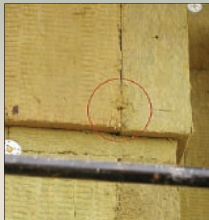
Дюбель был установлен в место приклеивания теплоизоляционной плиты в угловой зоне без соответствующего закрепления в основании.
