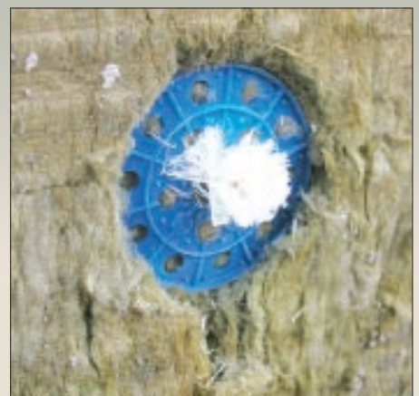
При монтаже использовались сверла не соответствующего диаметра, что привело к разрушению и неправильной установке дюбелей со стеклопластиковыми сердечниками.
