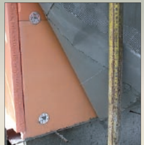
При монтаже теплоизоляционных плит не проводилась операция ошкуривания, что привело к потере адгезии армирующего и клеевых слоев
