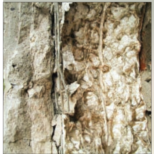
В системе теплоизоляции использовались теплоизоляционные плиты мягкого или «рулонного» типа, с низкой плотностью, непригодные и не предназначенные для систем теплоизоляции «мокрого» типа
