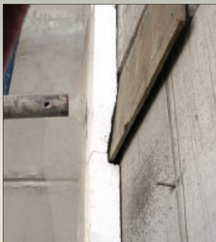
Монтаж теплоизоляционных плит ведется на неподготовленное основание (остатки опалубки)
