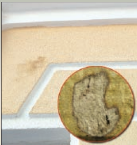
Темные пятна на декоративном слое вследствие выхода из минераловатных плит большого количества связующего через армирующие и отделочные слои
