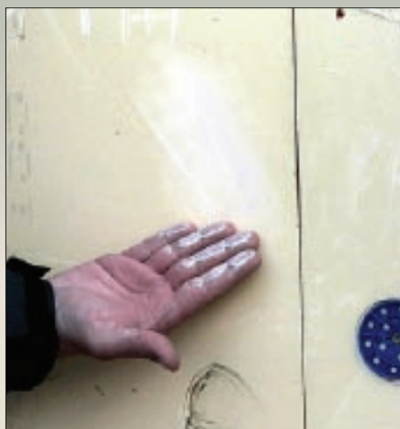
Допущено продолжительное хранение плит из пенополистирола при прямом солнечном излучении без защиты и необходимой консервации (плиты пожелтели и мелятся)
