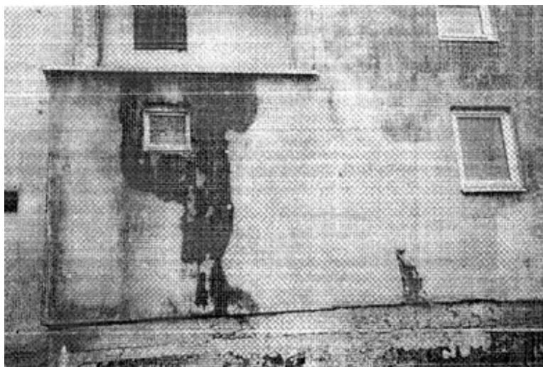
Рис.7.1 Применение в качестве утеплителя минераловатных плит, не предусмотренных для данного вида работ.
